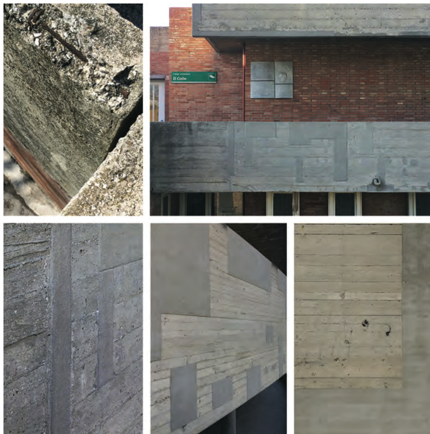
Fig. 195 Collegi Universitari, Urbino. In alto da sinistra: fenomeni di espulsione del copriferro e di ossidazione e corrosione delle barre d'armatura; integrazioni di De Carlo in un parapetto del Collegio del Colle; dettaglio delle integrazioni di De Carlo realizzate con malte studiate ad hoc e superficie lievemente bocciardata; integrazioni successive realizzate con getti di materiali premiscelati; dettaglio della superficie liscia delle integrazioni successive. Foto: G. FAVARETTO, 2017.
