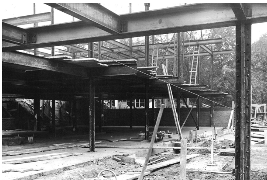
Fig. 185 Villa Tugendhat, Brno. Il cantiere dell'edificio con struttura in acciaio. P. PELČÁK, I. WAHLA, 2016, p. 43.
