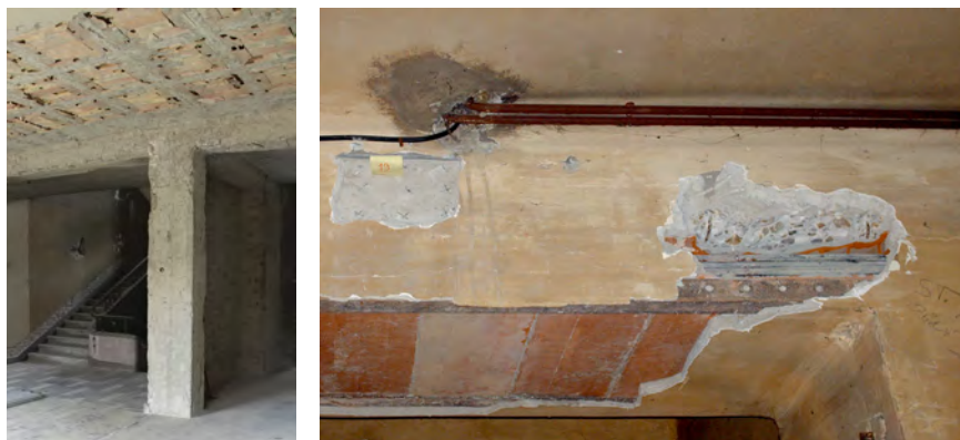
Fig. 110 C. Valle, Casa del Balilla. Da sinistra: solaio a nervatura incrociata; monumentalismo nelle travi. Foto: A. GENTILI, 2006-2010.
