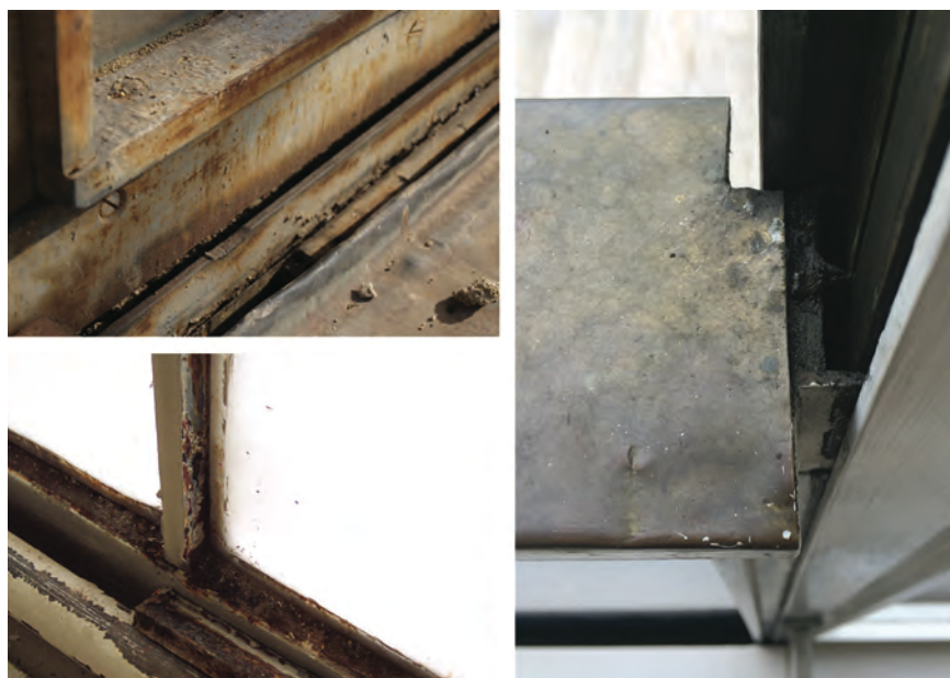
Fig. 232 Villa Tugendhat, Brno. Da sinistra: fenomeni di ossidazione e corrosione dei serramenti a matrice metallica del soggiorno e dell'atrio d'ingresso; stato di fatto di un infisso retrattile a intervento concluso. SDC-VT, Archivio digitale ; foto: G. FAVARETTO, 2017.
