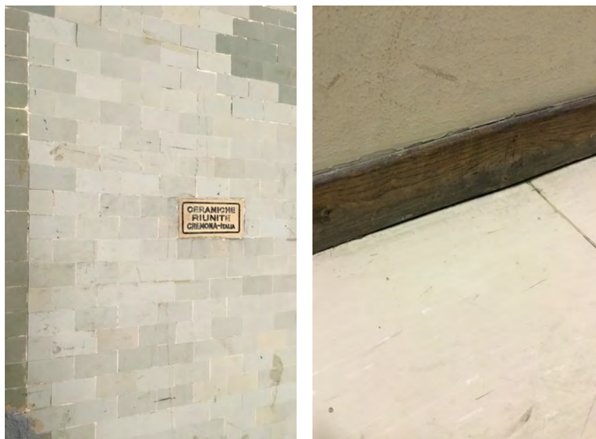
Fig. 140 C. Valle, Collegio Aeronautico. Da sinistra: integrazioni del grès ceramico; pavimentazione in Linoleum e battiscopa in legno. Foto: G. FAVARETTO, 2018.
