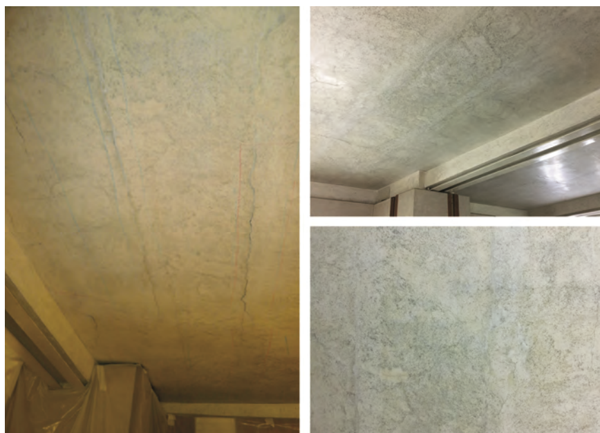
Fig. 222 Negozio Olivetti, Venezia. Da sinistra: superfici intonacate prima dell'intervento; superfici in calce rasata a intervento concluso. APL; foto: G. FAVARETTO, 2017.
