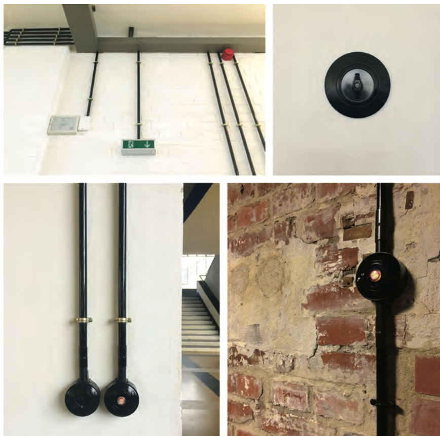
Fig. 255 Bauhaus, Dessau. Canaline del sistema impiantistico e nuovi interruttori. Foto: G. FAVARETTO, 2017.
