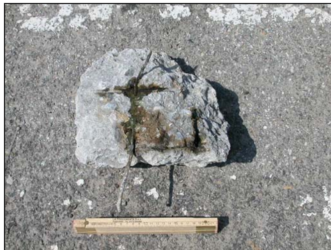
Fig. 5.3: Campione di lastra in cls armato
