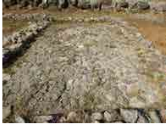
Fig. 190. La preparazione del piano pavimentale in scaglie e ciottoli nella stanza (I).
