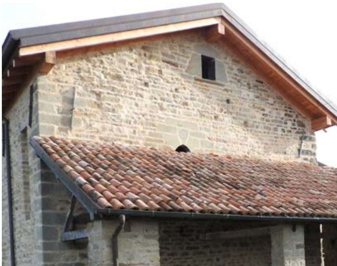
Fig. 20 - Stiano, Toano. Prospetto ovest. Dettaglio delle due finestre, delle quali quella che si apre sul piano abitativo risulta parzialmente tamponata dalla tettoia moderna.
