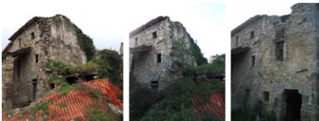
Fig. 8 - Pregheffio, Castelnuovo ne' Monti (RE), il CA1: evoluzione del degrado strutturale.
