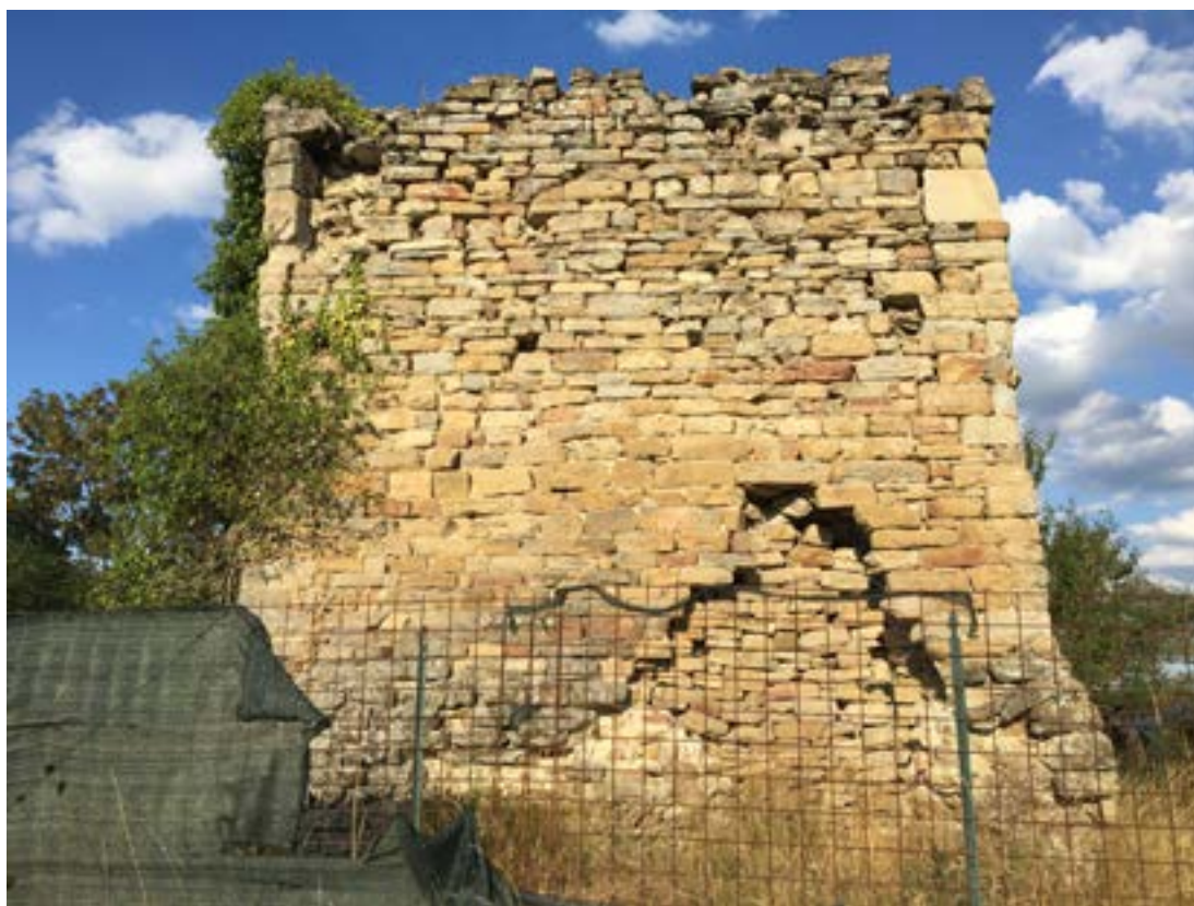
Fig. 42 - Massa di Toano, la torre medievale in grave stato di degrado.
