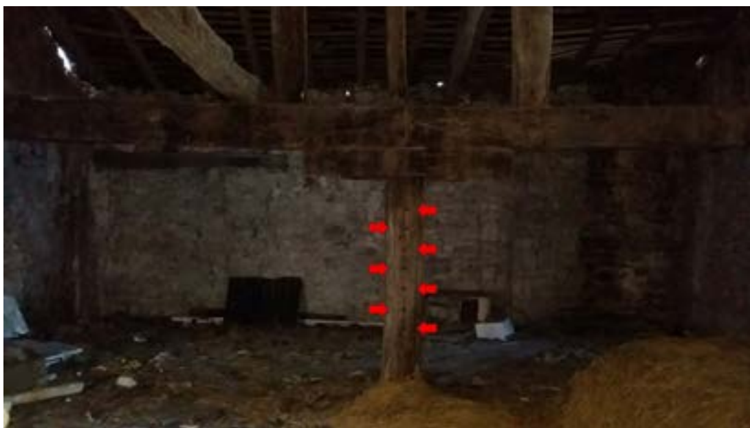
Fig. 13 - Gombio, Castelnuovo ne' Monti. Dettaglio della carpenteria lignea interna del CA1 e dei forti nella colonna lignea per l'alloggiamento di un tramezzo.
