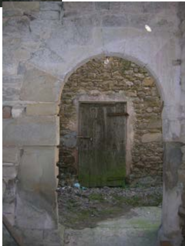
Fig. 18 - Pineto, Vetto. Edificio di Tipologia 2 con associazione di portale ad architrave triangolare al piano rialzato e portale con arco a tutto seso al piano terreno. Si noti il paramento murario in bozzette in fase con questi.
