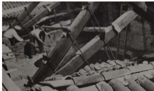
Fig.6 | III e definitiva proposta. Autore Arturo Danusso. Puntelli provvisori sulla navata laterale
