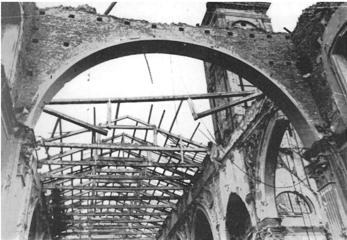
Fig.8 | Danni alle capriate e alle strutture
