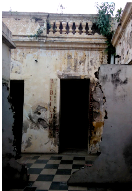
Fig. 2 – Il muro costruito e distrutto in parte alla fine del patio di ingresso
