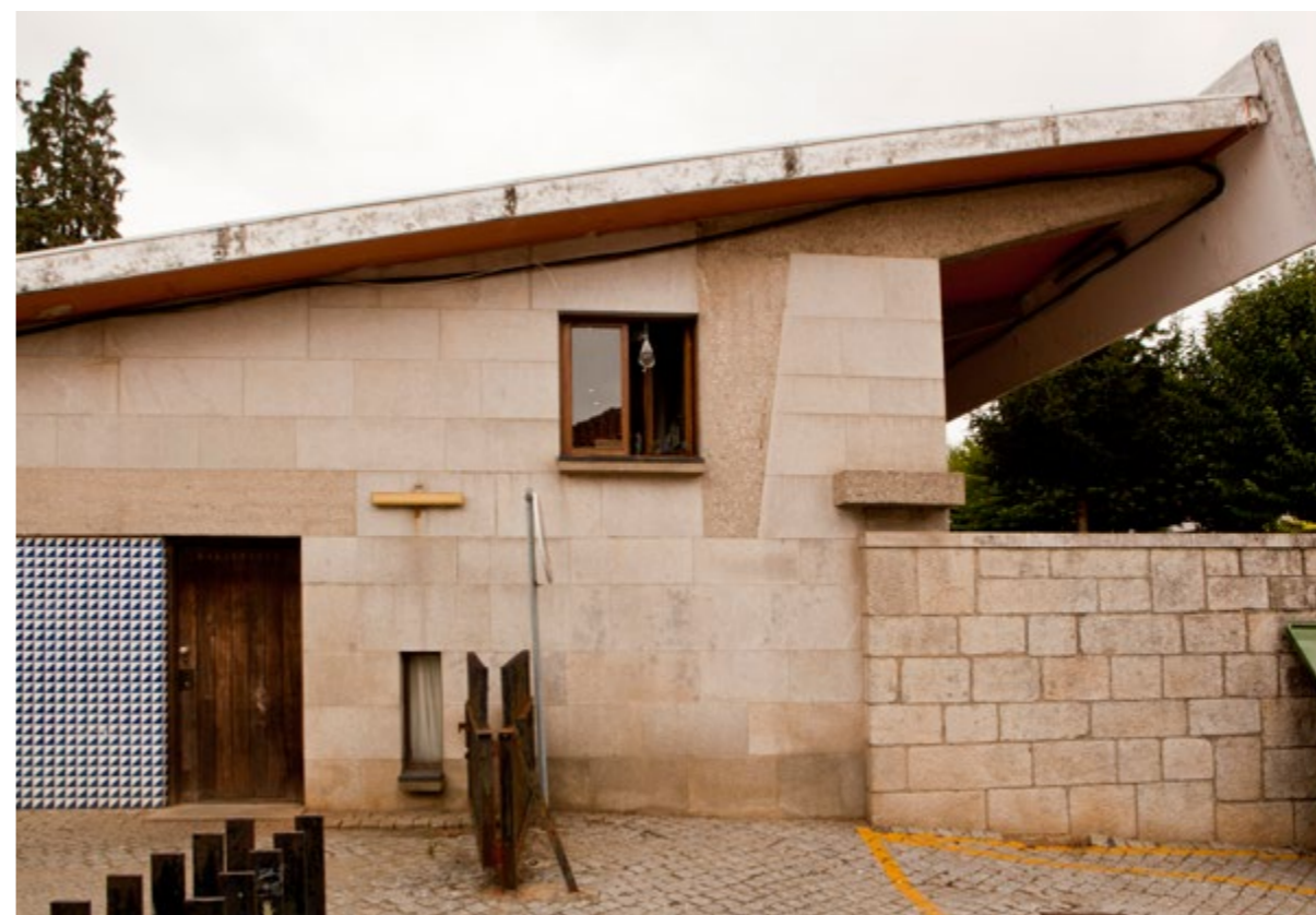
Fotografia di viaggio, Mercato di Vila da Feira di F. Távora, settembre 2015. Particolare della muratura e uso dei materiali.
