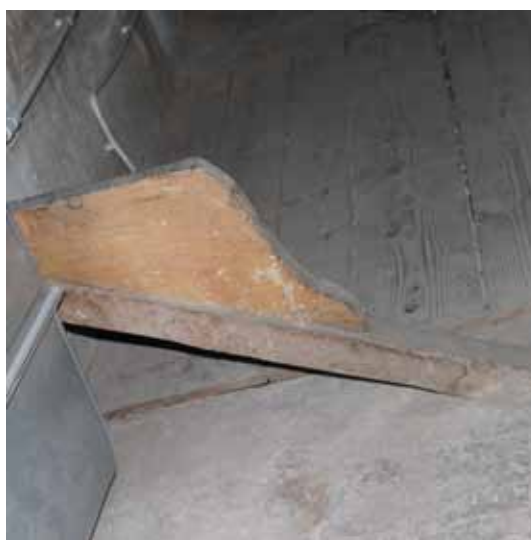
Figg. 126-127 – Teatro Comunale di Modena. Puntoni originari di contenimento delle spinte esterne della volta.
