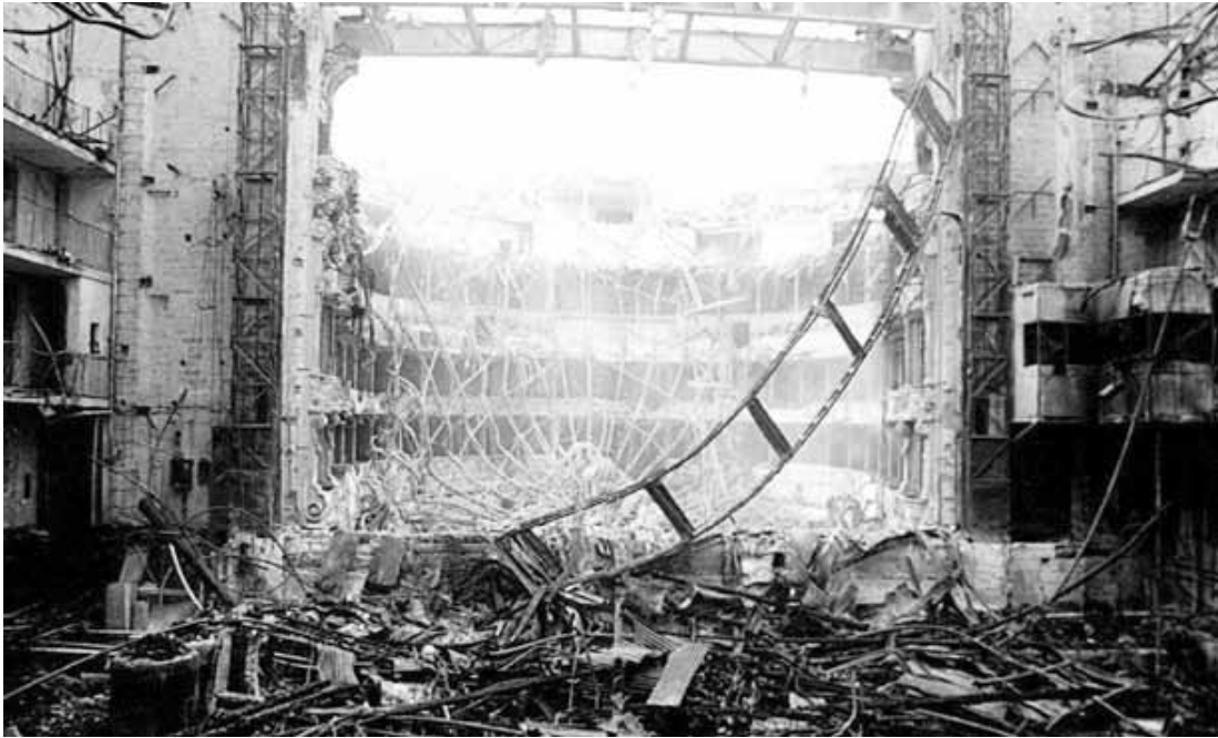
Fig. 26 – Bari, Teatro Petruzzelli (1903). La carcassa della cupola metallica dopo l'incendio del 1991.
