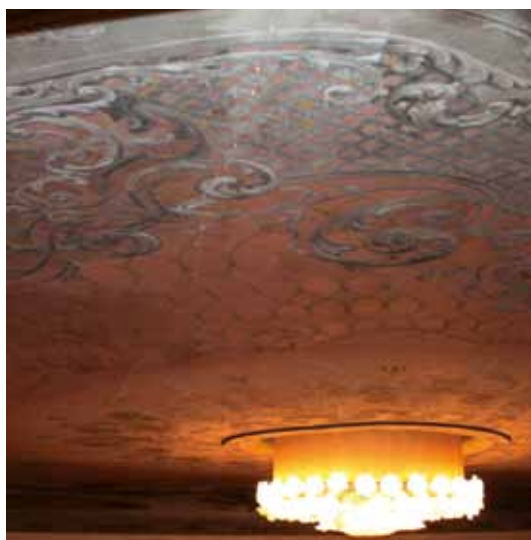
Fig. 164 – Teatro di Pieve di Cento. L'assenza di un sistema di controventamento è elemento di vulnerabilità contro le spinte fuori dal piano delle centine: si noti la nuova fessurazione che percorre la volta in direzione longitudinale.
