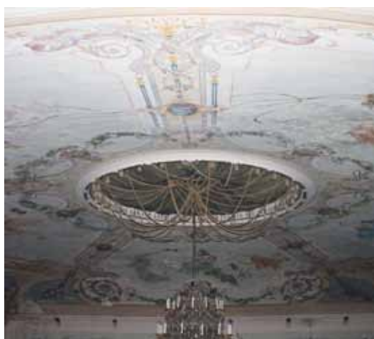
Fig. 179 – Teatro di Mirandola. Gli effetti delle infiltrazioni di acqua dalla copertura.
