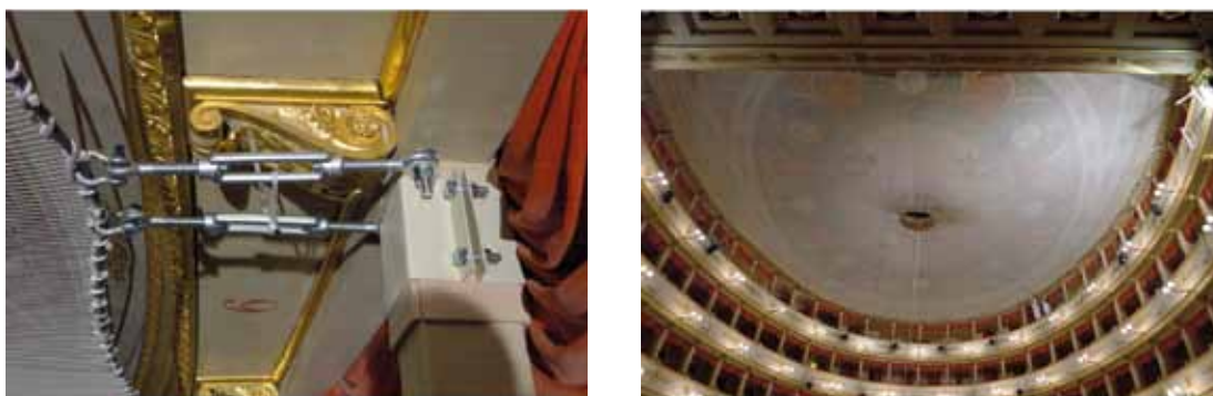
Figg. 42-43 – Interventi post sisma 2012. La rete di protezione della volta con particolare del montaggio al pilastro del loggione (A.U.T.C.Mo. Intervento di messa in sicurezza provvisoria mediante installazione rete di protezione sotto la volta. Documentazione fotografica).
