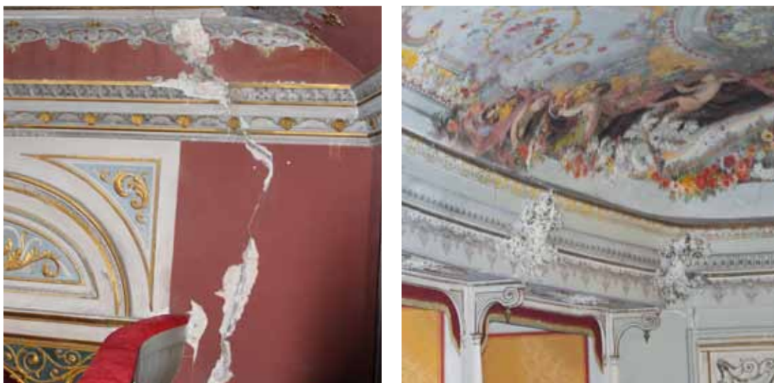
Figg. 148-149 – Teatri di Cento e Crevalcore. Lesioni dei cantonali d'angolo.
