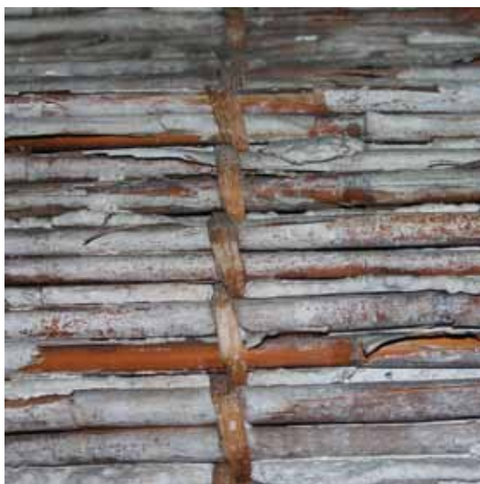
Fig. 51 – Teatro di Crevalcore. Il supporto in cannucciato della volta.
