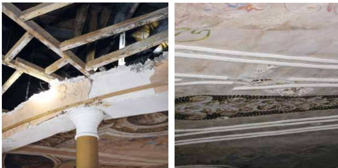
Figg. 3-4 – Plafone del Teatro Sociale di Novi di Modena. La rete metallica visibile in prossimità delle travi perimetrali lignee; si osservino le lacune di intonaco che lasciano intravedere la rete metallica del soffitto.
