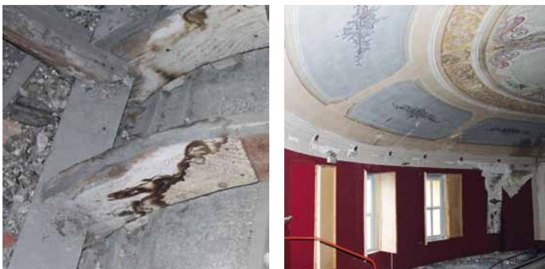
Figg. 72-73 – Teatro di Mirandola. A sinistra, si osservi l'appoggio non chiodato della centina per mezzo di semplice scasso delle tavole. A destra, si noti la lesione che corre lungo tutto lo sviluppo periferico della volta.
