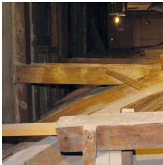
Fig. 166 – Teatro Comunale di Modena. Si osservino i puntoni di contrasto che impediscono movimenti relativi tra la volta e la parete.
