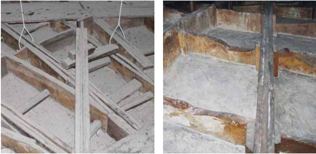
Figg. 171-172 – Teatro Comunale di Bologna e di Budrio. Si osservi la scabrosità delle superfici che ha favorito la formazione di macchie e muffe.
