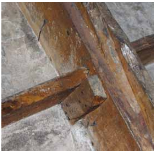
Fig. 58– Teatro di Budrio. Il sistema di fissaggio della rete metallica ai chiodi delle centine.
