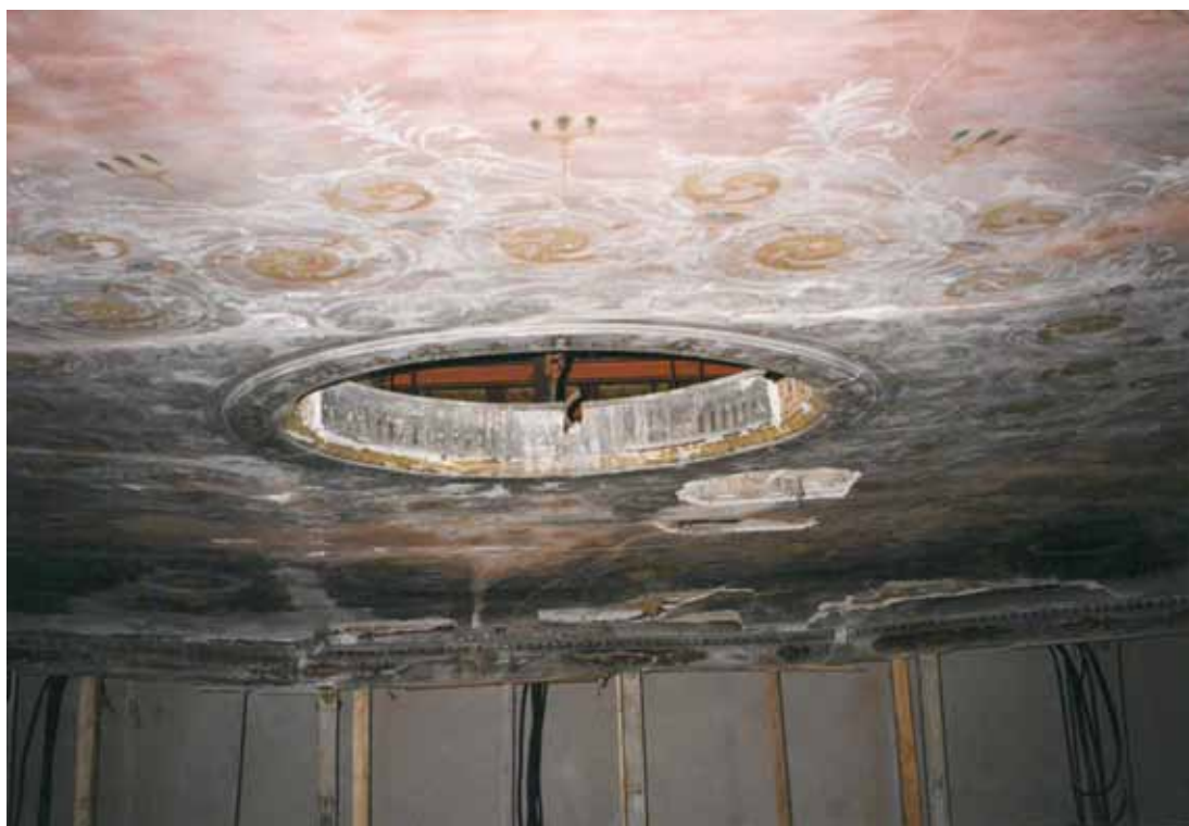
Fig. 157 – Teatro di Pieve di Cento. Foto di cantiere che ritrae il precario stato di conservazione del plafone in prossimità dei sostegni prima dei restauri del 2000 (Archivio dello studio Guido Cavina Roberto Terra Architetti)
