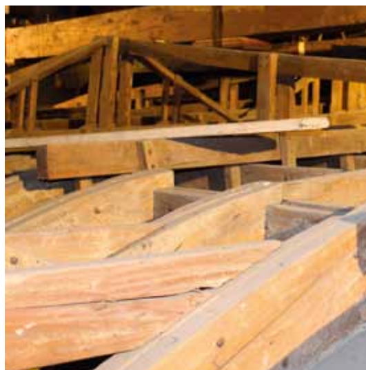
Fig. 169 – Teatro Comunale di Modena. Fenditura passante del puntone con andamento evidentemente condizionato dalla presenza del nodo.
