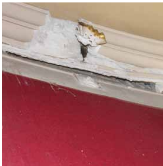
Fig. 153 – Teatro di Mirandola. Distacco del plafone dalla muratura perimetrale del loggione.
