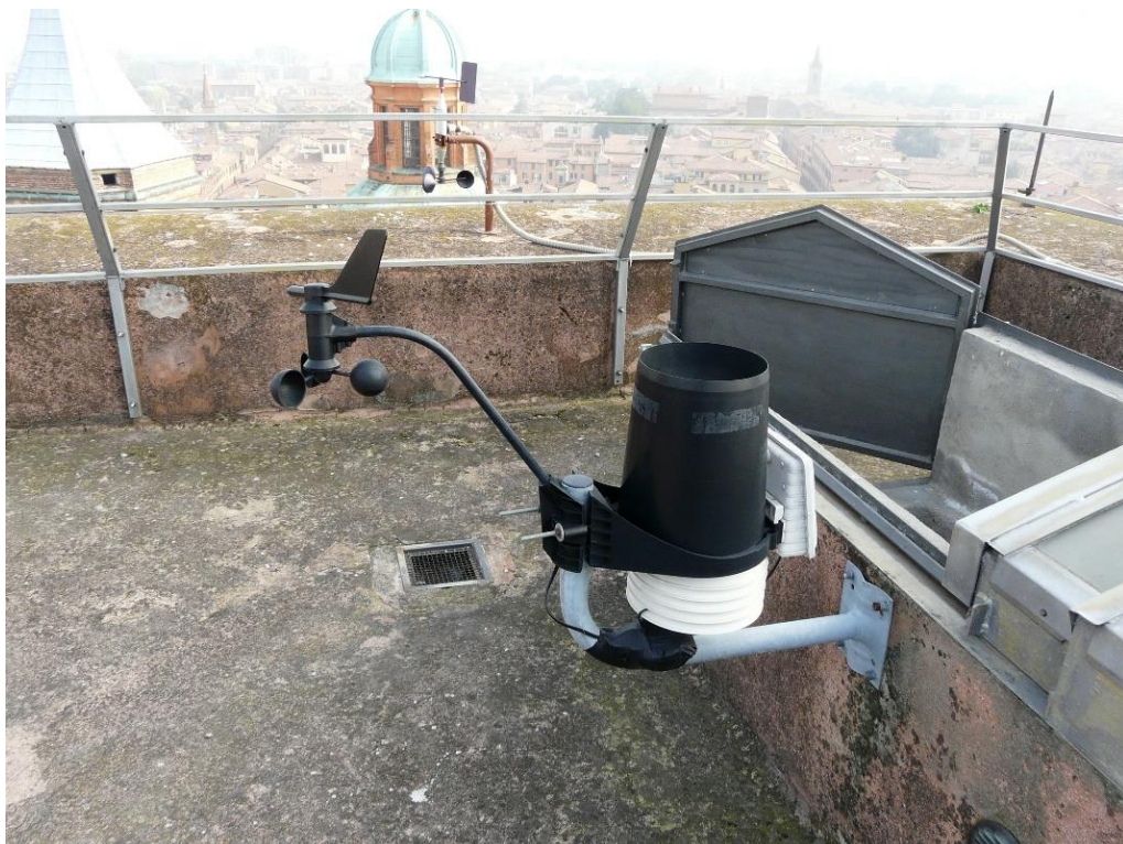
Figura 7.1 - Stazione Meteorologica installata dall'impresa Tecno In
