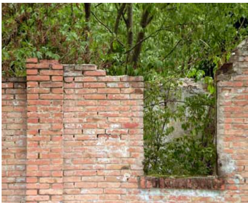
Ex campo di Fossoli dettaglio di una baracca dopo il terremoto 2012
