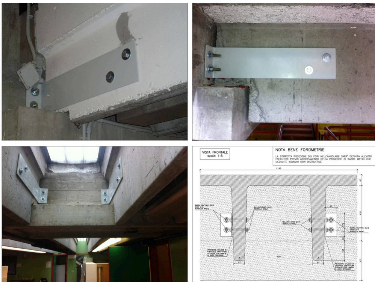
[Fig. 79-82] Interventi di ripristino delle connessioni tra travi e pilastri (in alto) e tra tegoli e travi (in basso), svolti per la Scuola Media “Guercino”, sulla base del progetto del DICAM (Università degli Studi di Bologna) e realizzati dall’Impresa Schiavina Srl. L’I.C. n.9 “Guercino” appartiene al piano integrato di realizzazione di cinque Istituti Comprensivi nel Comune di Bologna realizzati secondo il medesimo progetto, tra cui anche l’I.C. n.1 “Dozza”, oggetto di analisi: infatti, i meccanismi di danno e le patologie di degrado riscontrati in questo fabbricato risultano essere i medesimi fra i fabbricati identici.
