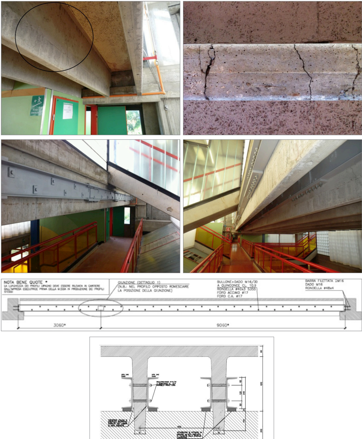
[Fig. 83-88] Interventi di consolidamento e risanamento delle fessurazioni, svolti per la Scuola Media “Guercino”, sulla base del progetto del DICAM (Università degli Studi di Bologna) e realizzati dall’Impresa Schiavina Srl. L’I.C. n.9 “Guercino” appartiene al piano integrato di realizzazione di cinque Istituti Comprensivi nel Comune di Bologna realizzati secondo il medesimo progetto, tra cui anche l’I.C. n.1 “Dozza”, oggetto di analisi: infatti, i meccanismi di danno e le patologie di degrado riscontrati in questo fabbricato risultano essere i medesimi fra i fabbricati identici.
