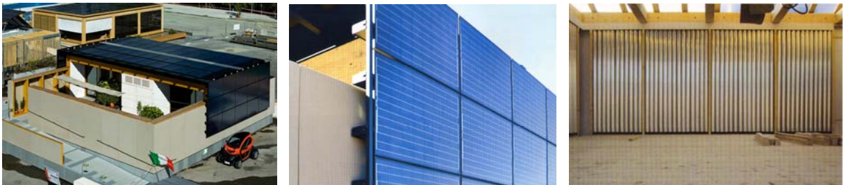
Viste generale da sud-est (fig. 3.53); dettaglio del rivestimento laterale in pannelli fotovoltaici (fig. 3.54); dettaglio della controparete in tubi di alluminio riciclato riempiti di sabbia con funzione di accumulo termico (fig. 3.55)
