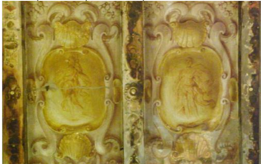
Fig. 4.32 Palazzo di via San Felice, 65. Immagine dei lacunari rettangolari dipinti dei quaderletti ornati con roselline dorate.
