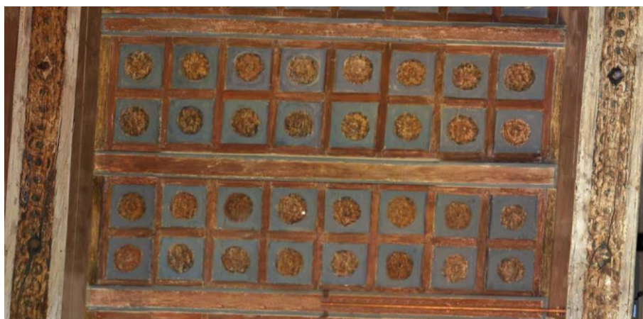
Fig. 4.17 Casa Bovi-Tacconi, piazza Santo Stefano, 15. In alto rappresentazione del fotopiano dell'intradosso del solaio. In basso particolare delle caselle con regoli. Da notare come i due asenari siano stati disposti a formare tre grandi campi suddivisi in dieci ambiti rettangolari, a loro volta scanditi da caselle quadrate. In ogni ambito sono alloggiati due file da otto caselle quadrate, tranne che per il campo posto in corrispondenza della parete obliqua in cui il numero delle caselle varia da otto a dieci. Questa precisa suddivisione, da cui appare evidente come elementi con valenza strutturale (asenari e quaderletti) e apparato decorativo (regoli e controregoli) siano ordinati da un unico disegno progettuale, contribuisce a normalizzare le forme irregolari della sala.
