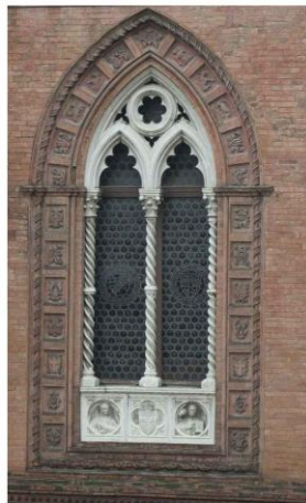
Finestra di destra della facciata del Foro dei Mercanti, p.zza della Mercanzia, 1 (1384 - 1391)
