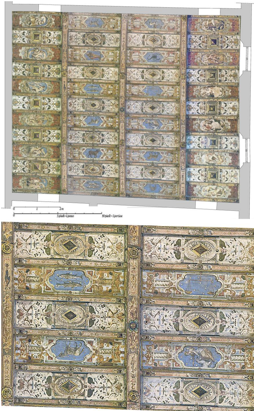
Fig. 4.20 Palazzo Fava-Marsili, via Marsili, 6. In alto rappresentazione del fotopiano dell'intradosso del solaio. In basso particolare dei lacunari. I 3 asenari dividono la sala, di forma pressoché rettangolare, in quattro campate. Ogni campata è costituita da 11 lacunari riccamente dipinti al cui centro è inserito un decoro ligneo dorato presente anche sull'intradosso degli asenari.
