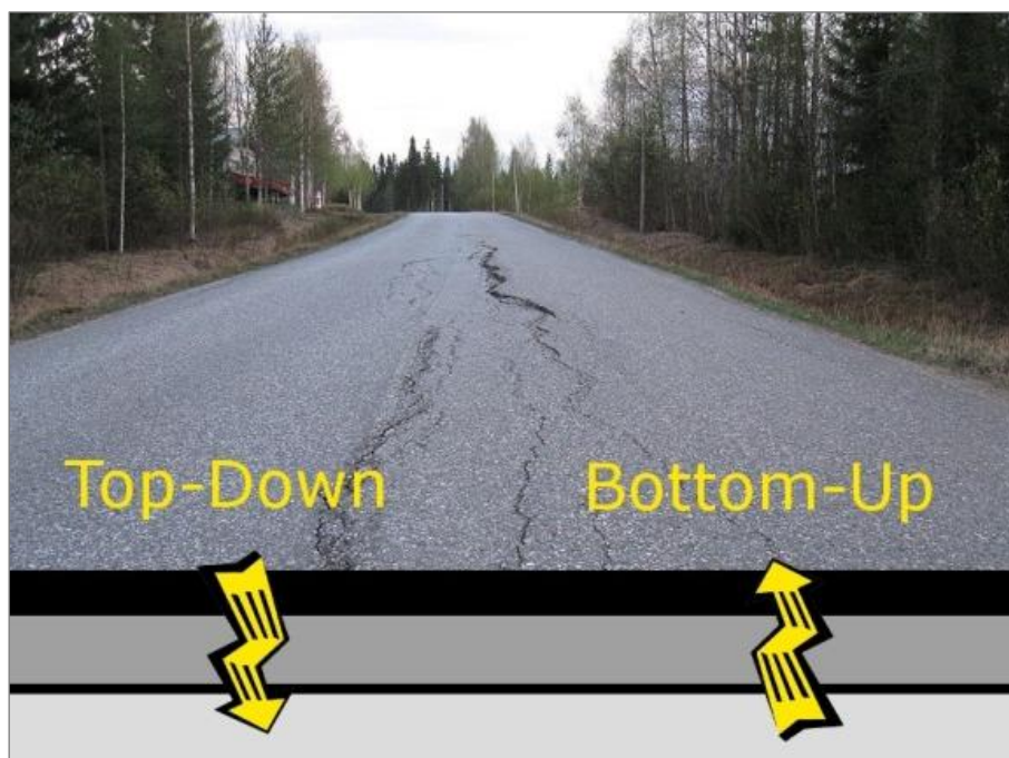
Figura 6.24: Propagazione delle fessure nelle pavimentazioni stradali.
