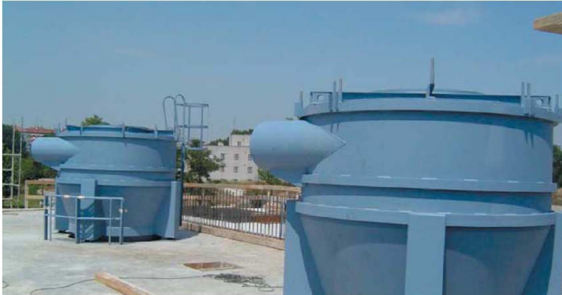
Figura 7.10: Cicloni di separazione del sistema pneumatico installato a Salburua (settori 7, 8, 9, e 10 di Vitoria-Gasteiz, nei Paesi Baschi).
