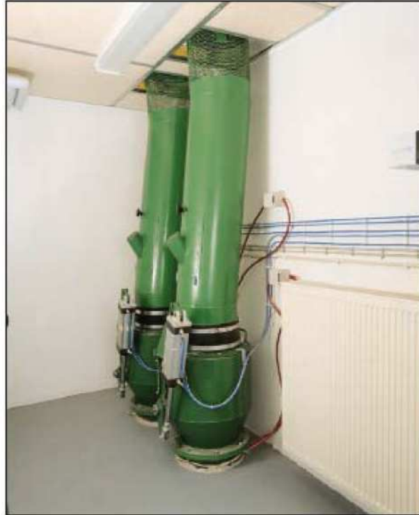
Figura 6.12. Valvole dei rifiuti all'interno della centrale di raccolta
