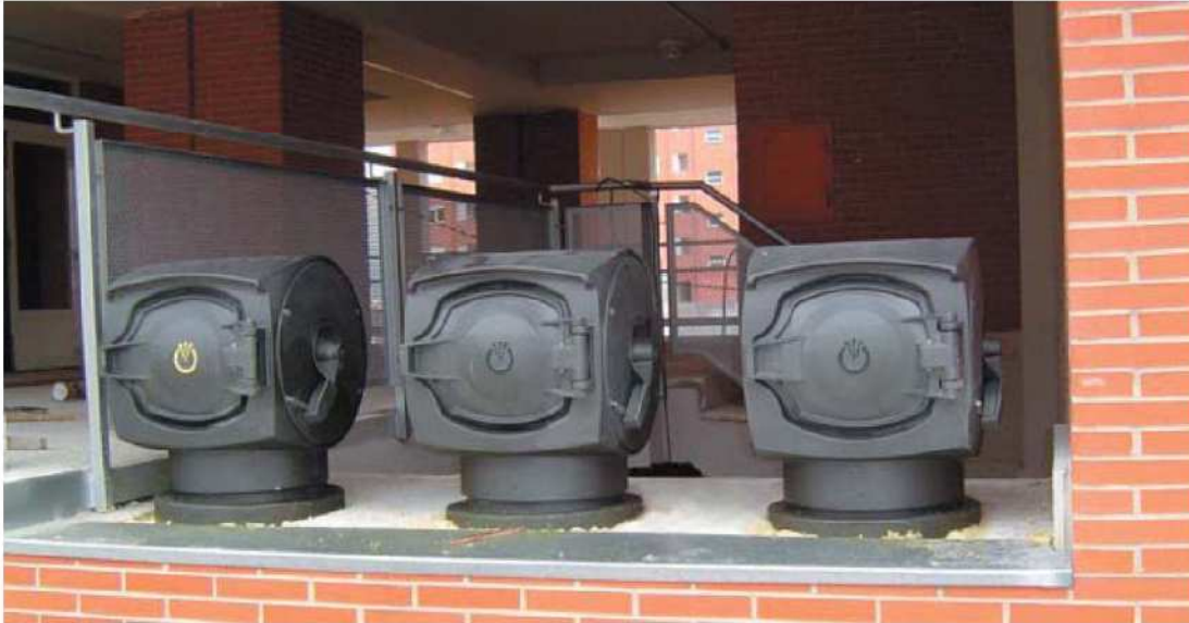
Figura 7.16: Chiusini di raccolta integrati nell'atrio condominiale di un edificio a Zabalgana.
