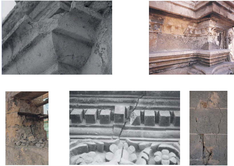
Fig. 44 – Immagini delle forme più comuni di degrado riscontrate sulla facciata della Chiesa di S. Michele in Cagliari.
