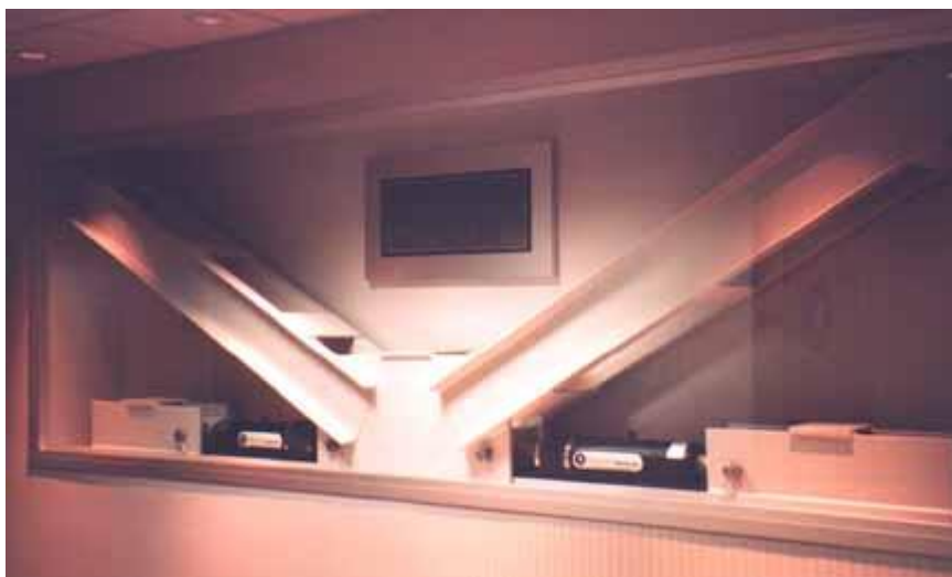
Figura 1.23 Installazione dei dispositivi nel Pacific Bell North Area Operations Center
