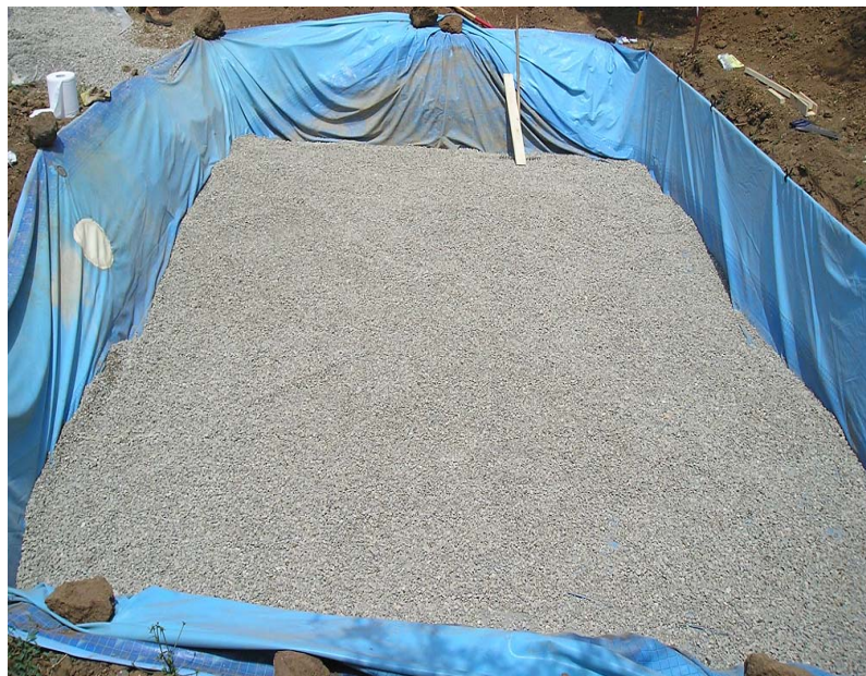
Figura 6.4 - Posizionamento del telo impermeabile utilizzato per l'isolamento idrico della vasca (in blu) e di uno strato di circa 0.13 m di materiale ghiaioso.
