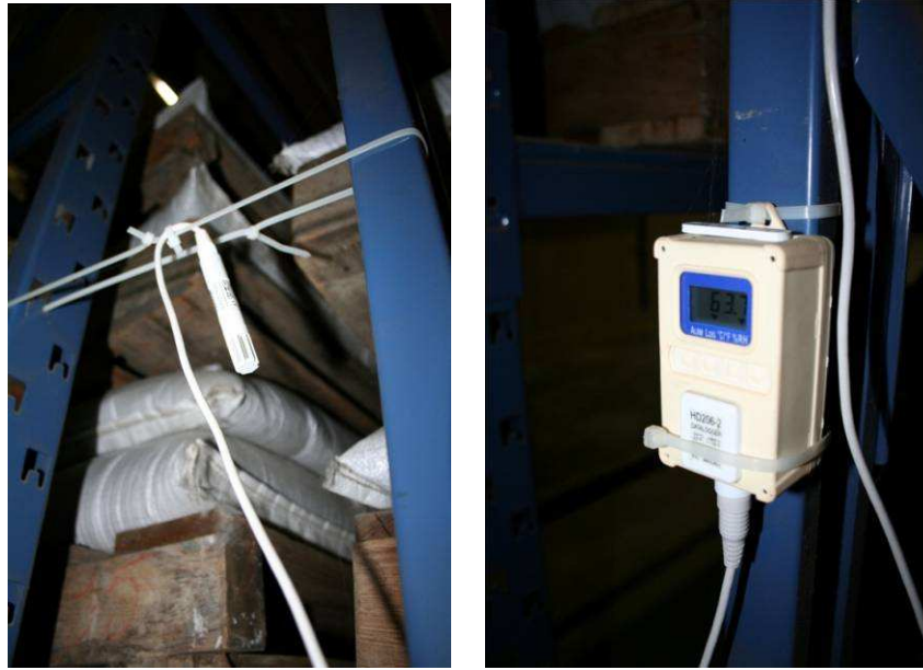
Installazione del Sensore e del Datalogger all'interno del magazzino
