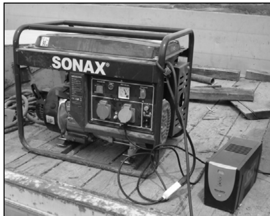
Figura 5.9 Generatore elettrico e gruppo di continuità per l'alimentazione del sistema STB ed il filtraggio del segnale.
