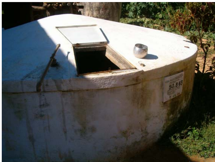
Figura 317 Cisterna de placas. Vale do Jequitinhonha.
