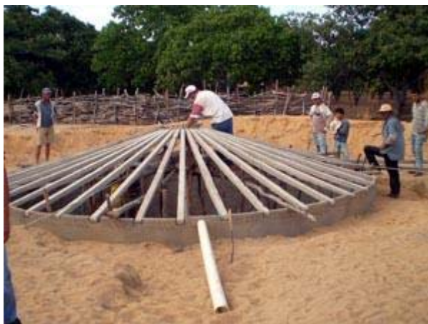
Figura 360 Cisterna Calçada. Semi Arido Brasileiro. IRPAA.
