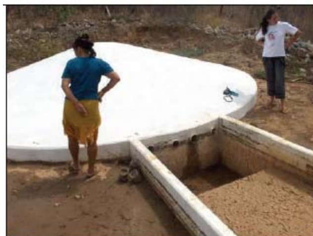
Figura 357 Cisterna caldação. Semi Arido brasileiro. IRPAA.
