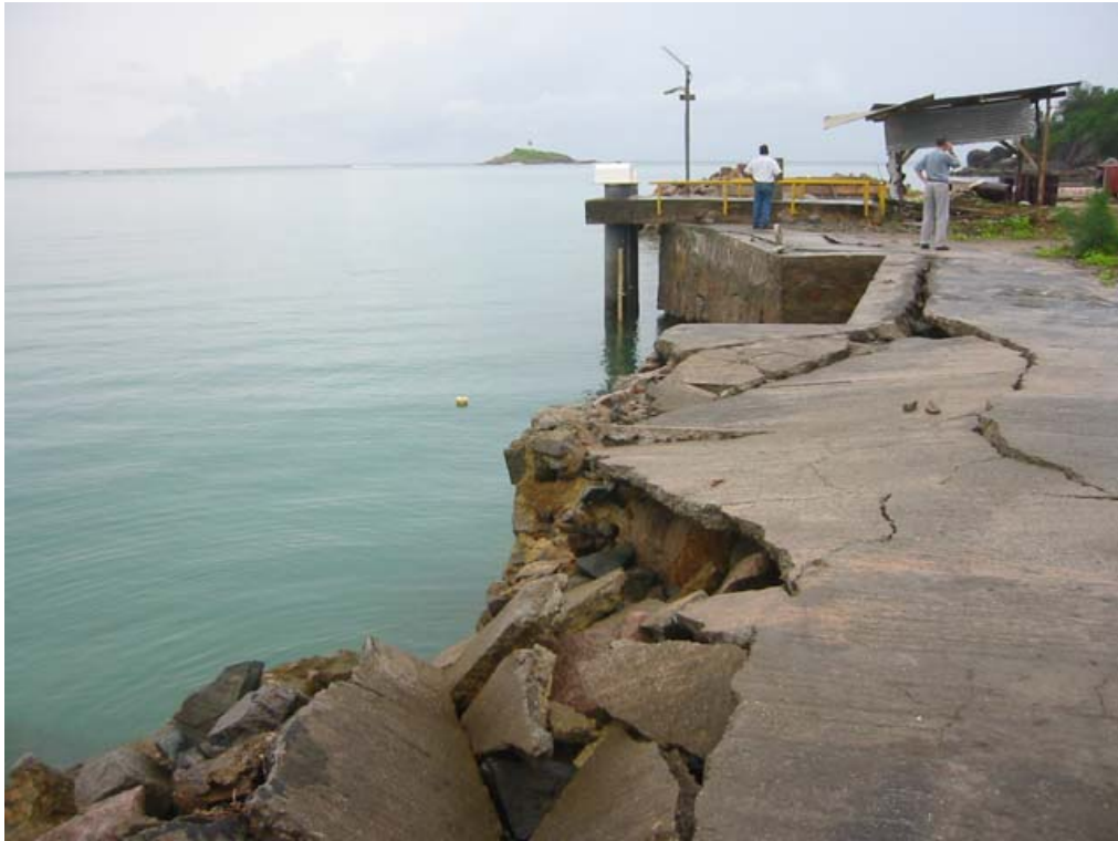
Figura 4.5: Tide gauge di Pointe La Rue. Danni strutturali alla banchina nella parte esterna del molo, Jackson et al., 2005, Effects of the 26 December 2004 Indian Ocean tsunami in the Republic of Seychelles/Report of the Canada-UNESCO Indian Ocean Tsunami Expedition)
