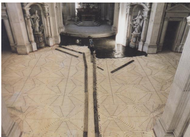
Figura 21_Chiesa di Sant'Uberto: impianti di riscaldamento con serpentina a pavimento 138
