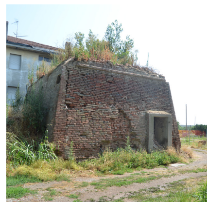
Basamento di Torre di corte Malcantone, Medolla, (Fda 2014)
