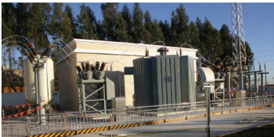
Figura 3.23: Limitatore SFCL 35kV/90MVA installato nella utility CNC [15]
