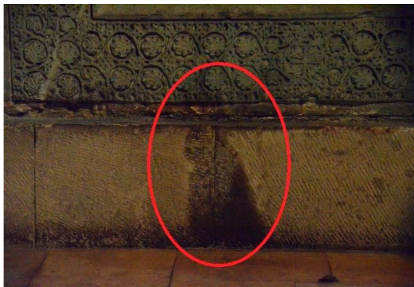
Figura 4: esempio di danno da acqua. Umidità di risalita nella struttura dell'iconostasi della chiesa di Svetitskhoveli, Mtskheta (Georgia).
